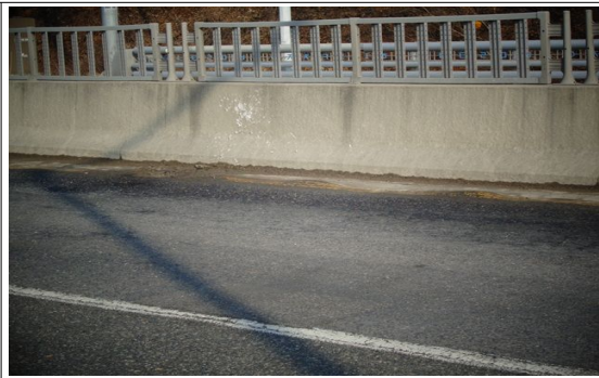
S32 망상균열 및 소성변형 (원주방향)
