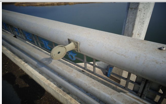
S23 델리네이터 파손 (양평방향)
