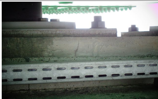
P23-SH1 무수축물탈 균열 (원주방향)
