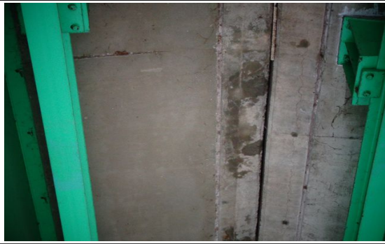
S141 균열부 누수흔적 (원주방향)
