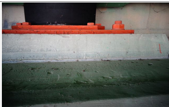
A1-SH3 무수축물탈 균열 (양평방향)
