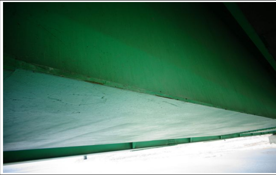
S24 부식 및 도장박리 (원주방향)
