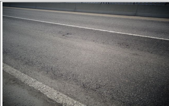
S15 망상균열 및 소성변형 (양평방향)
