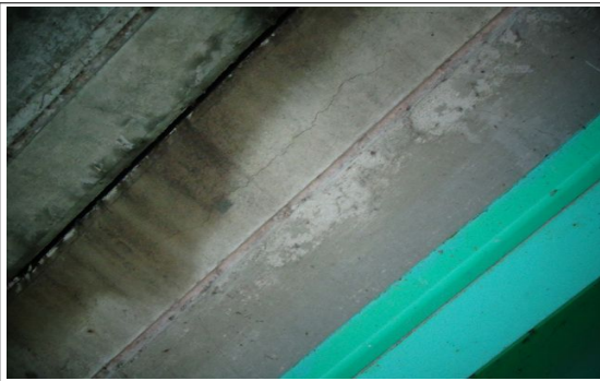
S27 폭 0.3mm이상 균열 (양평방향)
