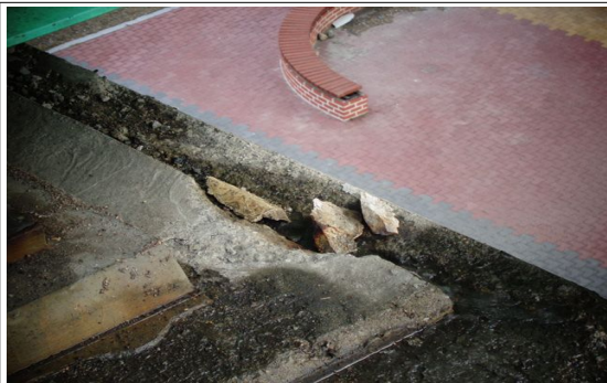
P11-SH1 받침 콘크리트 박락 (원주방향)
