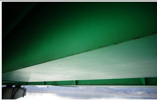
S26 부식 및 도장박리 (원주방향)
