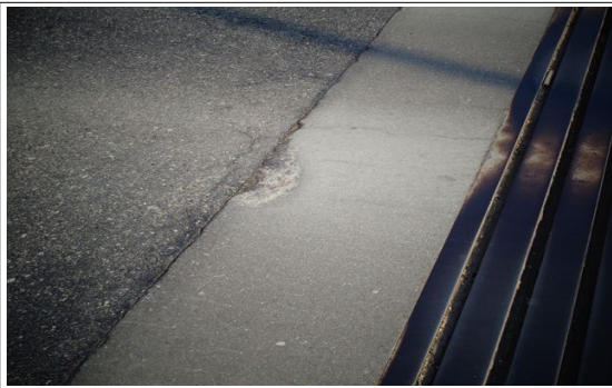
P11 후타재 파손 (원주방향)
